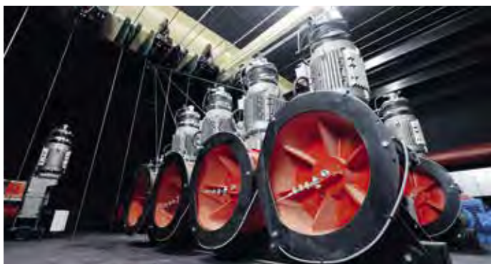
Beckhoff eszközökkel vezérelt, négy egységből álló ponthúzó gépesoport
