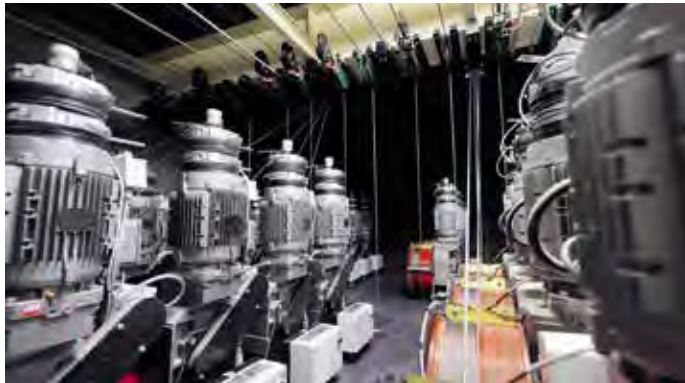
Hangszigetelt gépházban elhelyezett ponthúzó gépcsaportok
