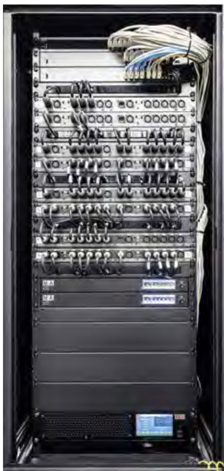
Gyengeáramú vezérlő rack
