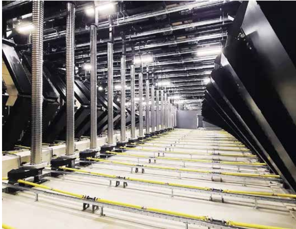
A vasbeton gerendához rögzített Spiralliftek a kardántengelyekkel
