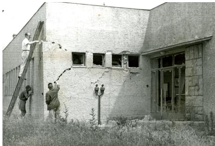
A főépület az 1953. július 3-i villanybojler robbanás után
