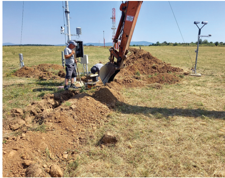
Pogány Repülőtér déli automata állomásának telepítése 2021-ben
