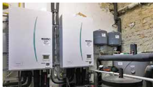
A kazán modernizálása is fontos része az energiatakarékosságnak
