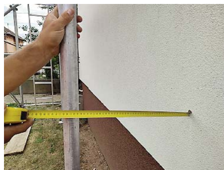
Az építési állvány és az épület homlokzata közötti 0,40 m távolság (munkavédelmi hatóság felvétele)
