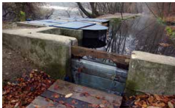
A nyersvízkivétel a Szalajka-patakból történik, monolit vasbeton műtárgyon keresztül
