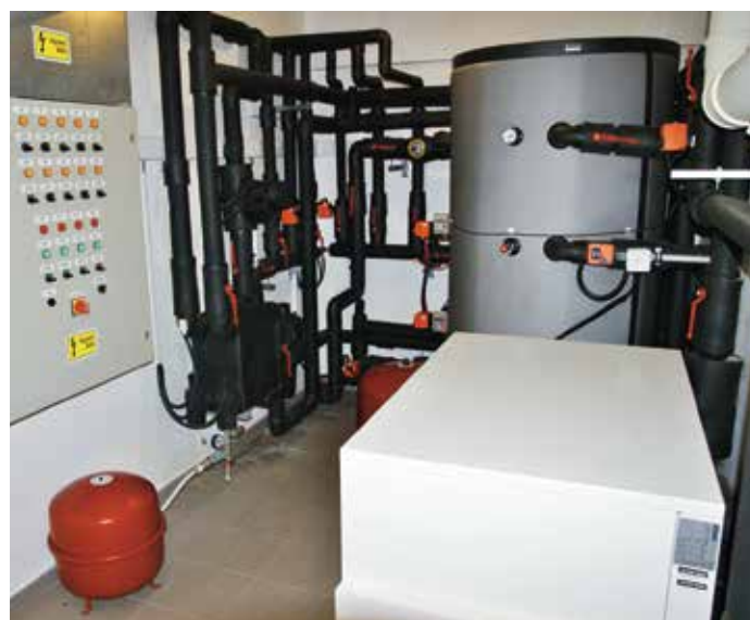
Hőszivattyú, Kecskemét I-es telep
