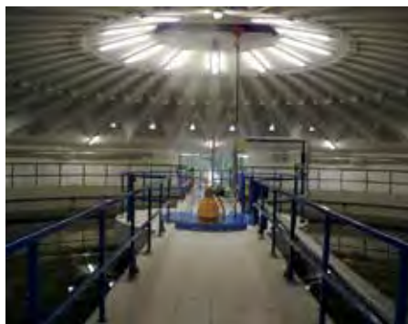
Derítómű a Mohácsi Vízműben
