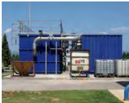
Membrántechnológia a Balatonöszödi Vízműtelepen
