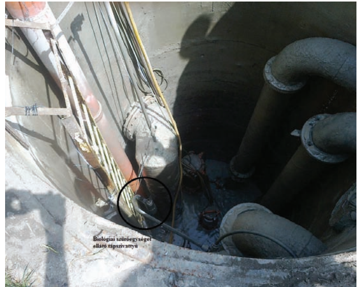
3. kép: Tápszivattyú az üres aknában
