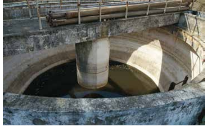
A Martfűi szennyvíztisztító telep egyik beton műtárgya (Fotó: Szőnyi Lajos)
