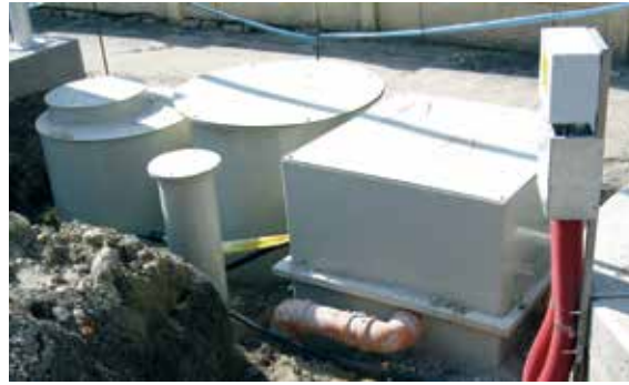
A szaghatást megakadályozó biofilter és kiegészítő műtárgyai
