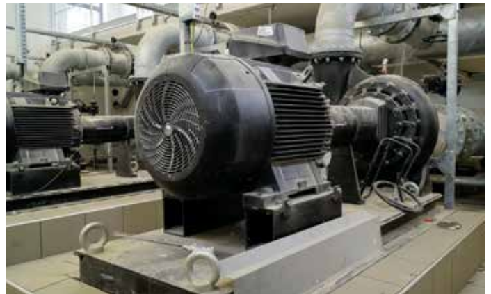
2. kép: Közbenő átemelő szivattyúk (Fotó: Temesvári Péter)
