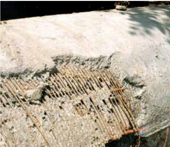
Szétrobbant feszítettbeton cső
