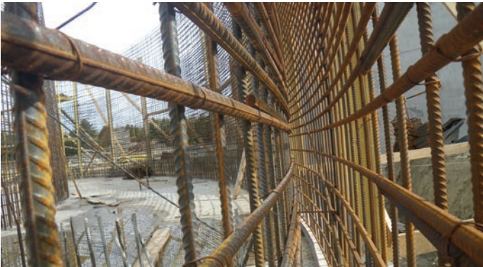
C-Tech medence vasalása, a betonozás maximum a méteres szegmensekből történhetett, így kellett megoldani a vízzáróságot
