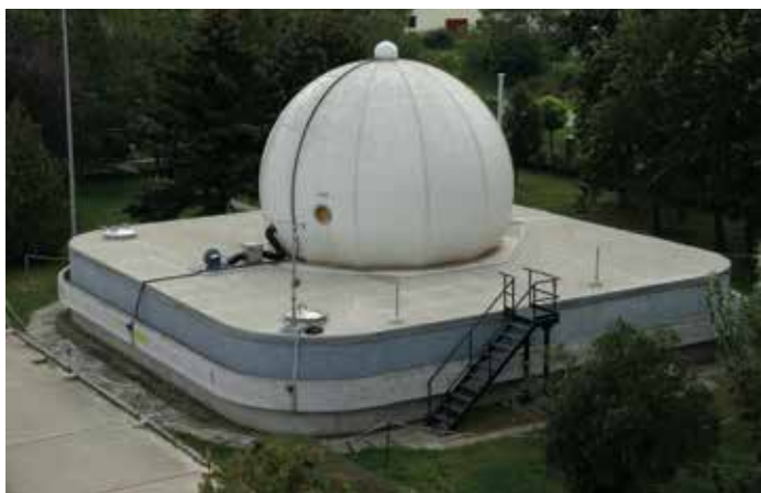
2. kép: Átépítés utáni rothasztó
