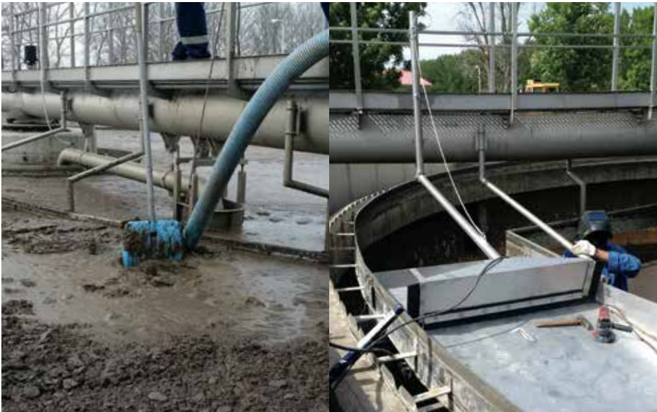
Utőüleptő fölőzője szivattyús megoldással, teljesen hatástalannak bizonyult, új gravitációs lefőlőzővel jelentősen csökkentek az üzemeltetési problémák (megállapodás előtt és után)
