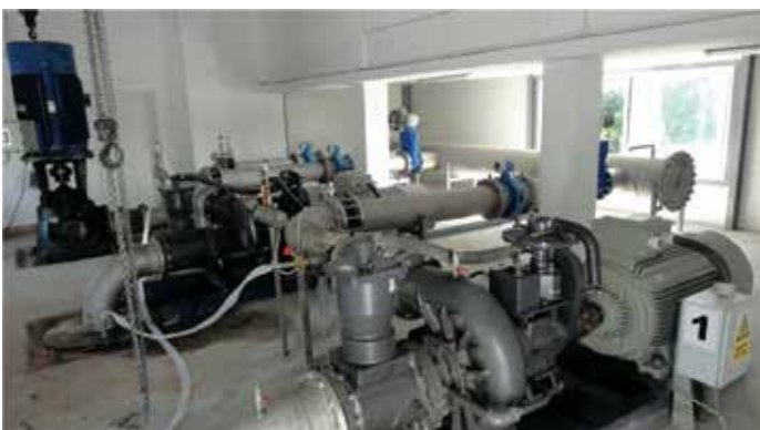
Új szivattyúk a gépházban
