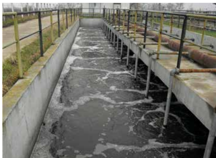
A biológiai blokk felújított levegőztetőgyertyákkal a szennyvíztelepen
