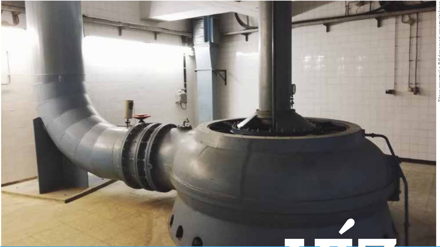
Zápor szivattyú a Békásmegyert szivattyútelepen
