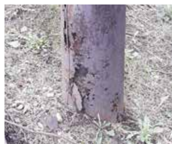
Jelentős mértékben korrodált, védelem nélküli kútfej-szellőzőcső kivezetés a talajon keresztül (a szerző saját felvétele, 2019)
