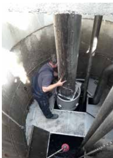
1. ábra: Függőleges, forgódobos finomrács telepítése
