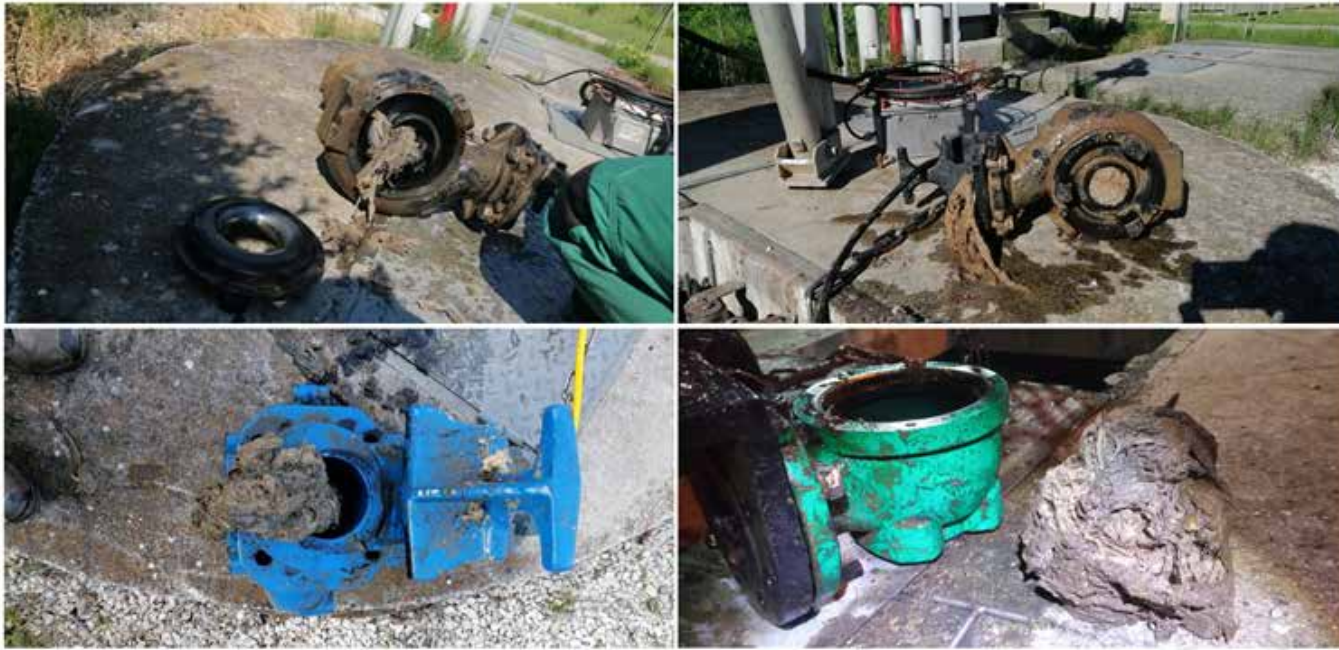
Szennyvízátemelő-meghibásodások a DRV Zrt.-nél
