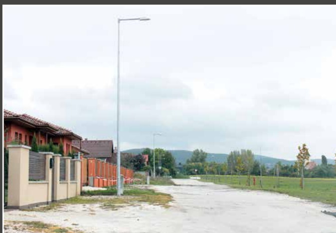
Északi lakóközvet közvilágítás-fejlesztés
