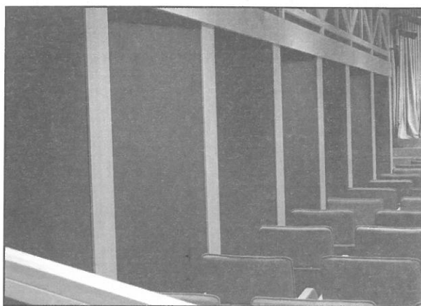
A Fő utca felőli oldalfal zajszigetelő felülete
