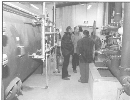
Automata tűzoltó-berendezés a Liegl-Dachser Kft. raktártelepén
