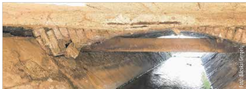
A csatorna feletti híd szerkezete meggengült, ezért kell lezárni az átmenő forgalmat
