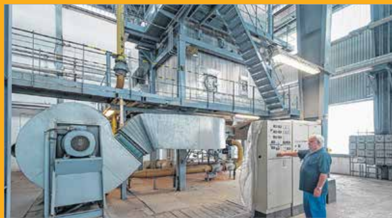
A nagy teljesítményű kazán indításának pillanata
