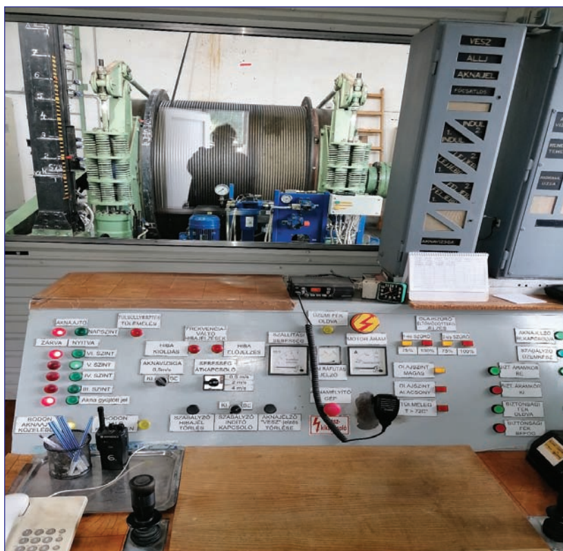
Akna szállító vezérlőpult
