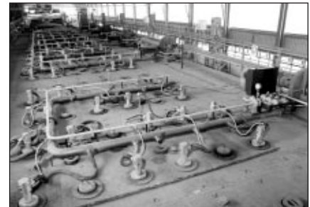
■ 9. ábra. Téглаégető alagútkemence földgáztüzelő berendezése
