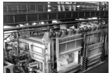
■ 12. ábra. 60 t kapacitású földgáztüzelésű Al olvasztó kemence
