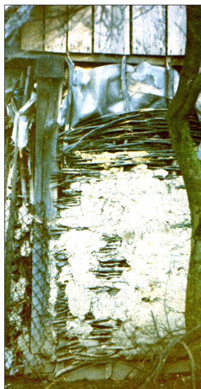
9. kép. Talpas-vázásól vízszintesen fonott fala (A szerző felvétele) A függőleges karók, jól láthatóan, a koszorúgerendához és a talpgerendához vannak szegezve. Korábban, igényesebb megoldásként a karók végeit a talp- és koszorúgerendába fűrt lyukakba illesztették.
