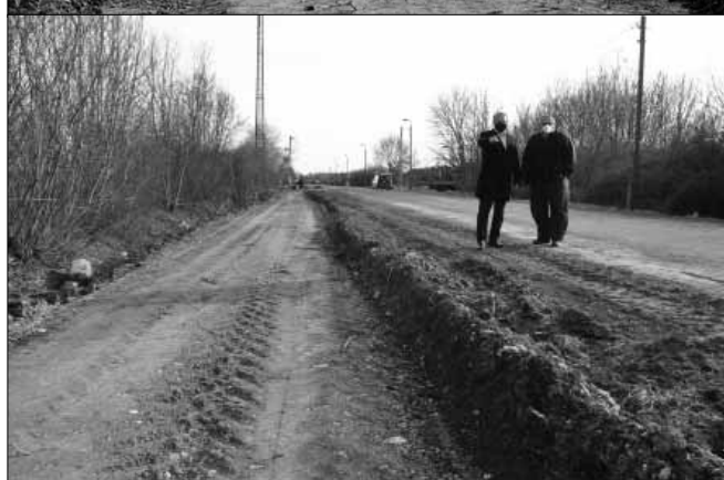
Jó útemben halad a kivitelezési munka az Anti úti kerékpárút-szakasz építésénél. A tervek szerint néhány héten belül elkészül az új kerékpárút
