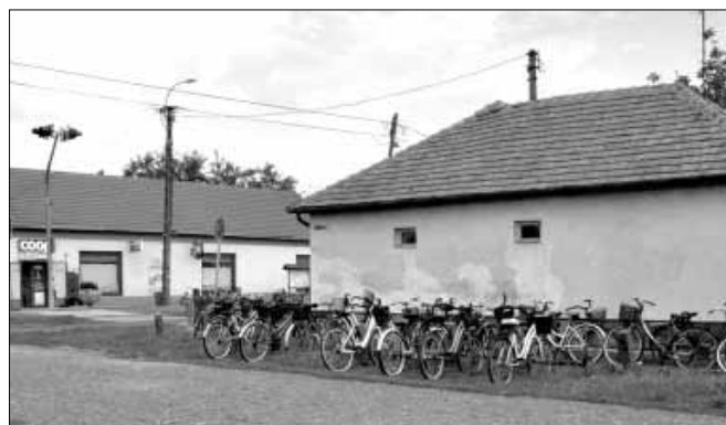
48 db kerékpár elhelyezésére alkalmas, fedett, térkő burkolatú kerékpártároló épül a Damjanich utca elején
