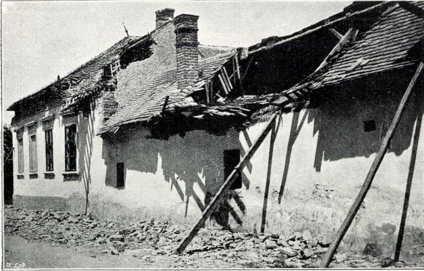
3. ábra. Súlyosan károsodott ház a Máriavárosban
