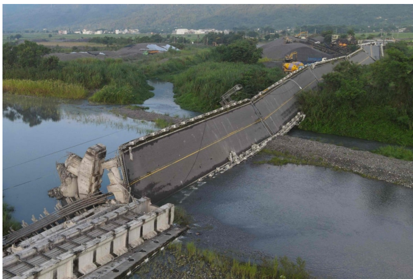
8. ábra. Légifelvétel 6,9-es magnitúdójú földrengés után a Tajvan keleti részén található Gaoliao híd összeomlásáról
