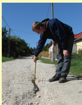
Petőfi utca kimosódott burkolata felhőszakadást követően
