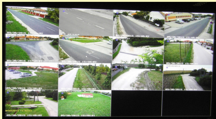
14 kamerás térfelügyelő kamerarendszer kiépítése.
