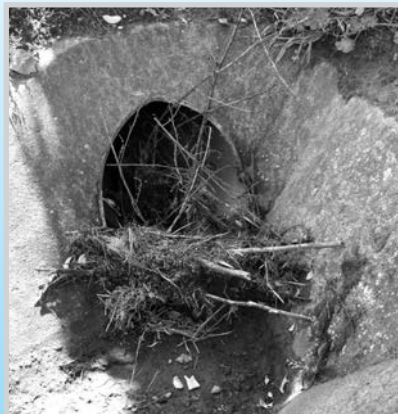
Az esővíz által sodort törmelék eltömítheti a csöveket
