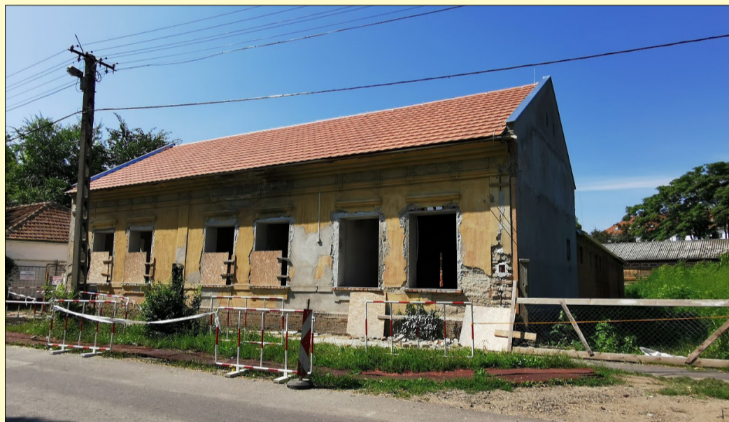
A védőnői centrum épülete felső képünkön az udvar felől a bővítménnyel, alsó képünkön az utca felől a felújítás alatt álló, régi épülettel
