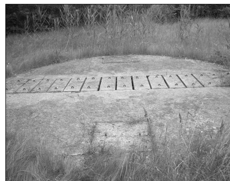
Az aknafedő betonlapok felnyithatók, gyermekekre balesetveszélyt jelentenek.
