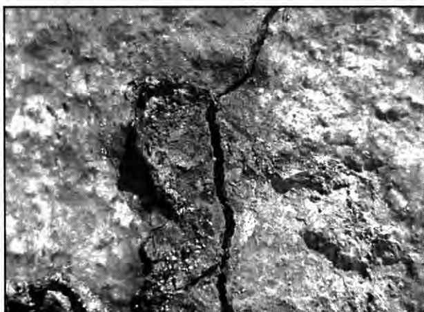
4. ábra Repedés a vasalás fölött
