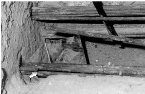
4. ábra Korrodálódott feszítőpásmák elszakadt acélszálai
