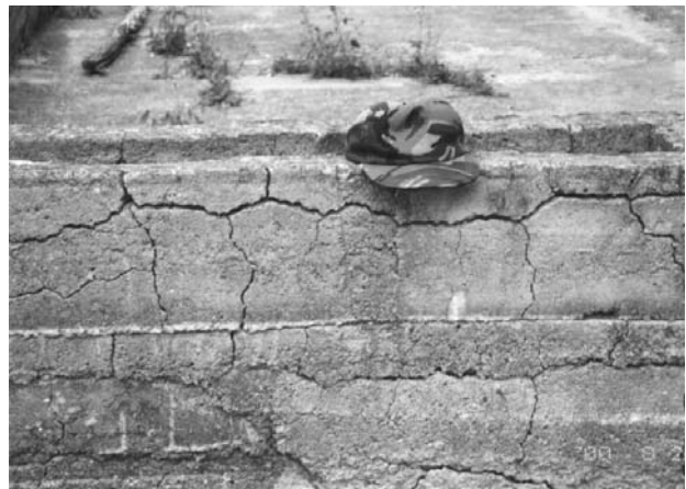
1. ábra Repedések a falon
