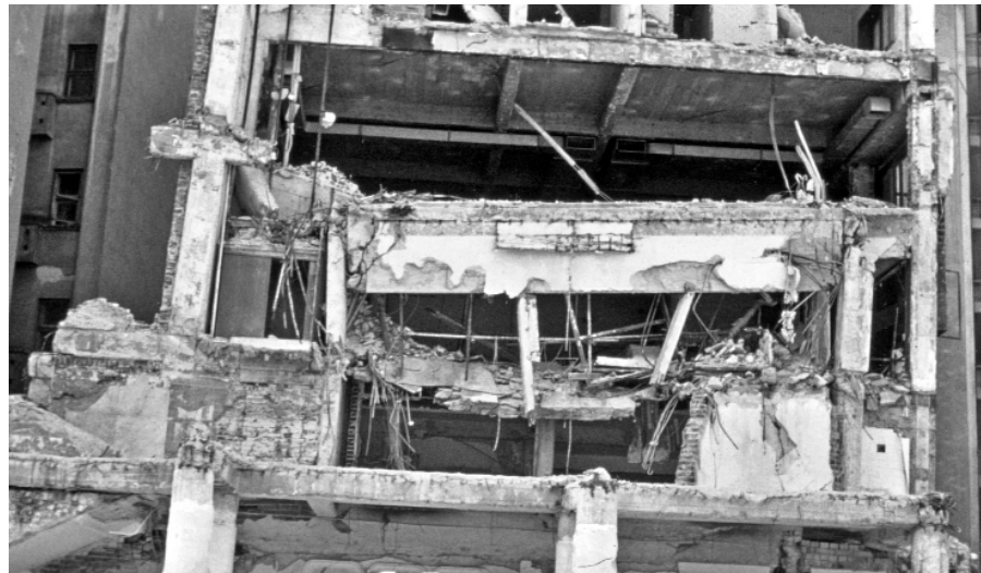
1. ábra Megrongálódott épület
