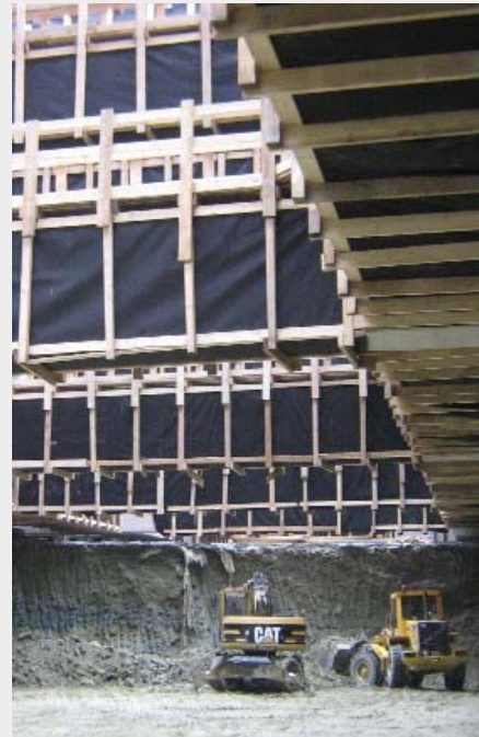
4. ábra A Népsház utcánál már védve van a látszóbeton
