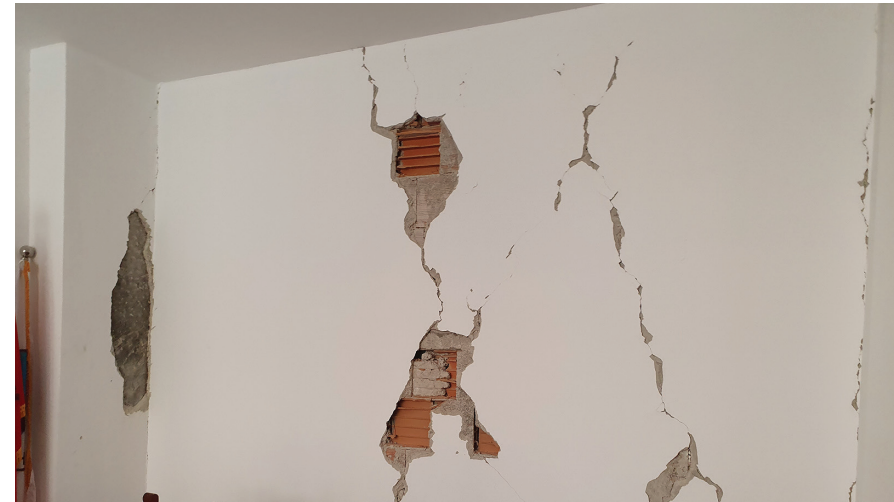
2. ábra Téglafalon keletkezett repedések, Tirana 2019 (fotó: dr. Nagy Róbert)
