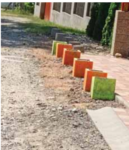
Színesre festett betonkocka elhelyezése balesetveszélyes
