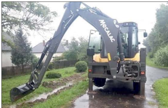
A lezúduló eső miatt Keresztúron is megteltek a csatornák, kotrógéppel kellett utat nyitni a víznek.
