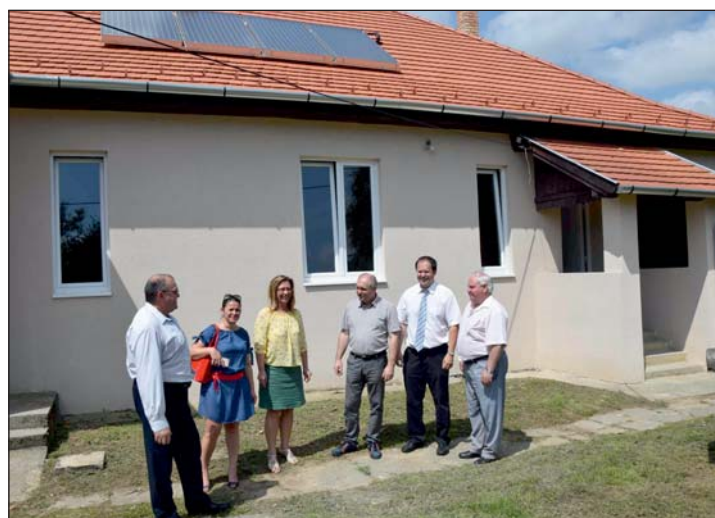
Lenti lentiszombathelyi városrészében a volt iskolaépület udvarán és épületében egy energiaudvar került létrehozásra.
