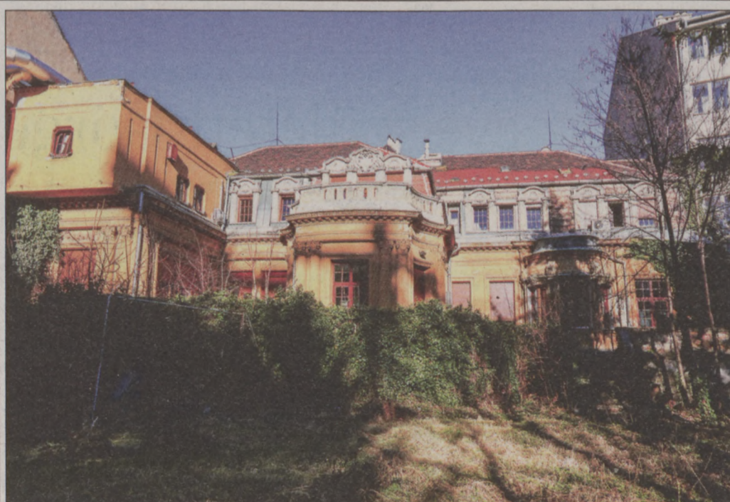
A szakrendelő belső homlokzatát is felújítják, a terasz alatt pedig új helyiséget alakítanak ki a vérévételhez
