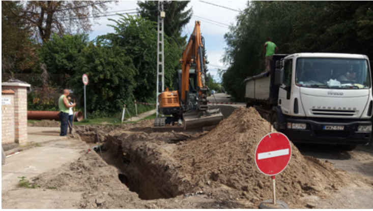
Az Ibolvás utca – Tanács József u. találkozásánál a csapadékvíz-elvezetés megoldása
