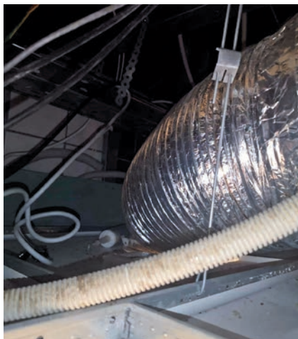
Tűzvédelmileg aggályos gépészeti elem zsíros levegő elvezetésére
