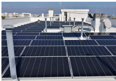
Nagy fényvisszaverő képességű lapostető-szigetelés, napelemlenszerrel
