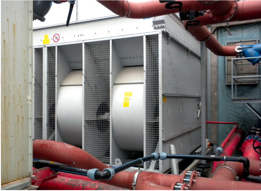
Zártrendszerű lágyított és kezelt víz permetezézéses hűtőtorony
