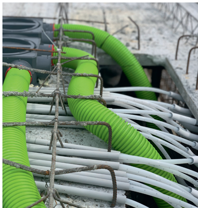
Klímafödém kontrollált szellőzési rendszer vezetékezésével (forrás: Leier)
