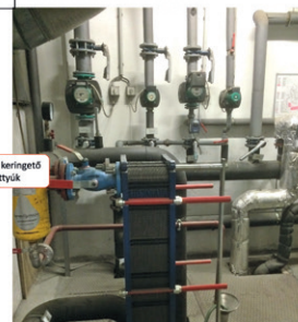
3. ábra: A hőátadásra telepített hőcserélő
